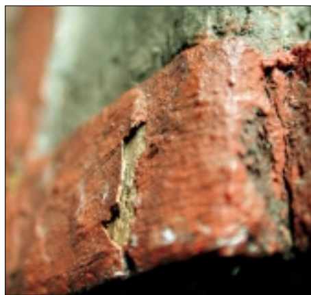
Maling har løsnet og står opp fra veden. Dette gir en åpning for tilførsel av lim.
