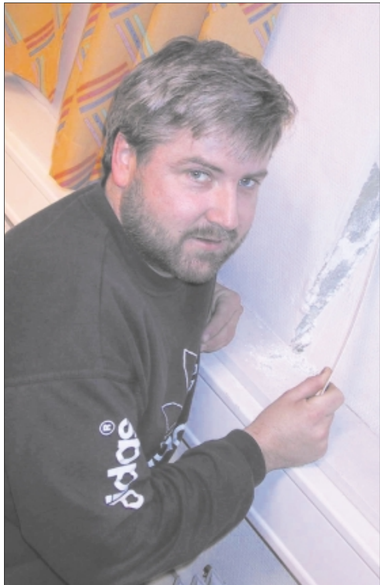
Soppskadene er tydelige på kontoret til Sturla Sørstad.
