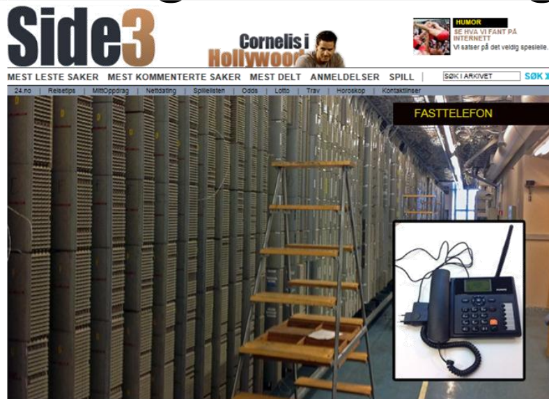
(MEDIEHUSET NETTAVISEN) Denne koblingssentralen for fasttelefoner i Oslo Sentrum er fra 30-tallet. Nå skal den demonteres. Det er starten på en prosess om å fjerne fasttelefonnettet innen 2017, men vil i første omgang ikke påvirke noen av kundene i Oslo.
