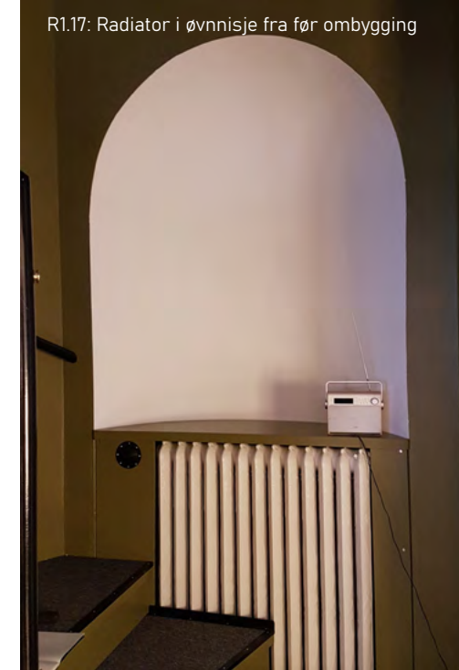
R1.17: Radiator i øvnisje fra før ombygging Foto: Kristin Marie Singstad
