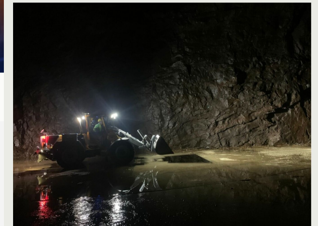
Dimensjonene er store i tunnelssystemene ved Torstad kraftverk, som er Norges største. Det avsettes så mye sand og grus at gravemaskiner og lastebærere må til for å få fjernet sedimentene. (Foto: Kaspar Vereide)
