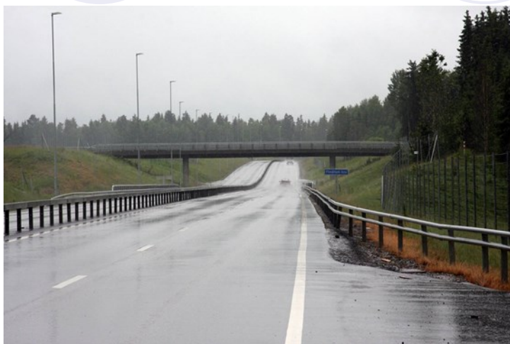
Deler av motorveien fikk omfattende telehivskader (Foto: Truls Tonmo, Teknisk Ukeblad)
