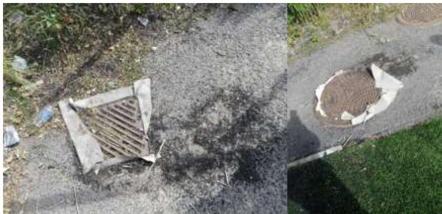
Oversikt over hvordan duk brukes i to overvannskummer på Risenga.
