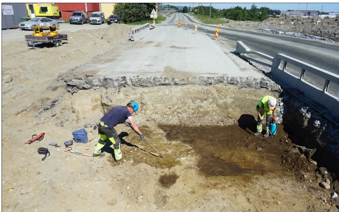
Figur 44. Rensing av strukturer, sett mot nord. Da64156_409. Foto: Kristoffer R Rantala, NTNU Vitenskapsmuseet
