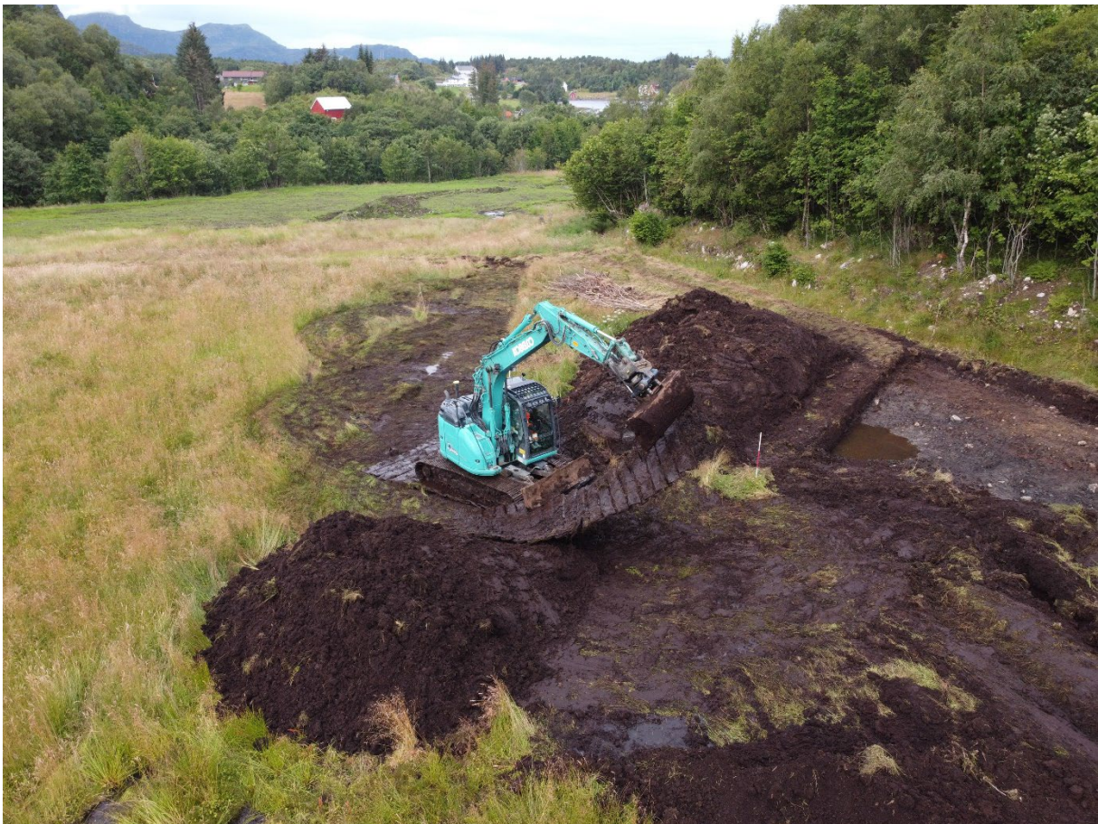
Figur 8. Det måtte hentes inn sprengningsmatter for at maskina skulle klare å jobbe. Sett mot vest. Da64407_192. Foto: Ingvild Skau Mjelde, NTNU Vitenskapsmuseet
