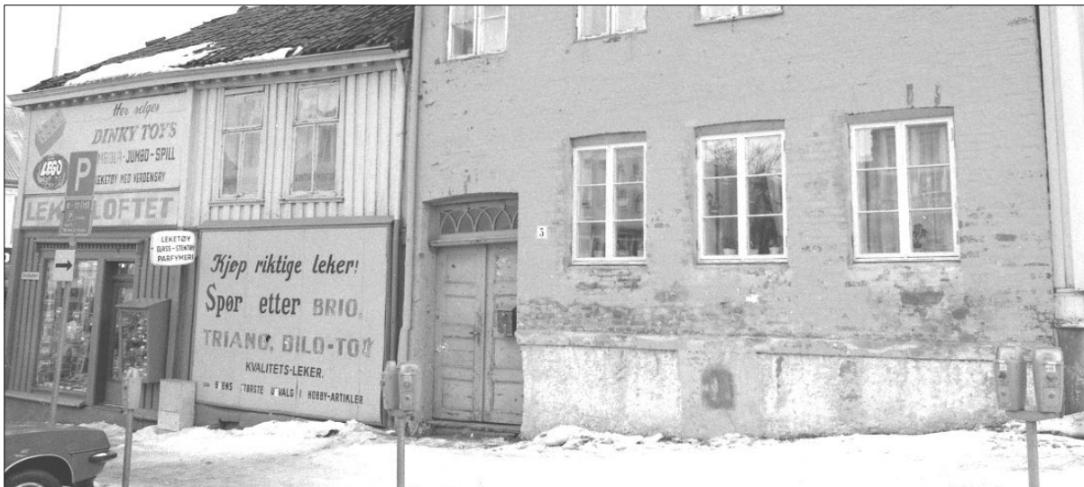
Figur 25. Kongens gate 43 (til venstre) og Smedbakken 5, 1979, mot nordøst. Foto: Byantikvarens Negativsamling (Film-008-008)
