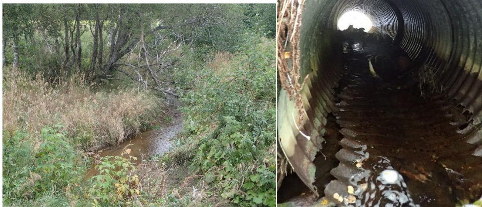
Bilde: Svartbekken og tilstoppet kulvert i bekken.
