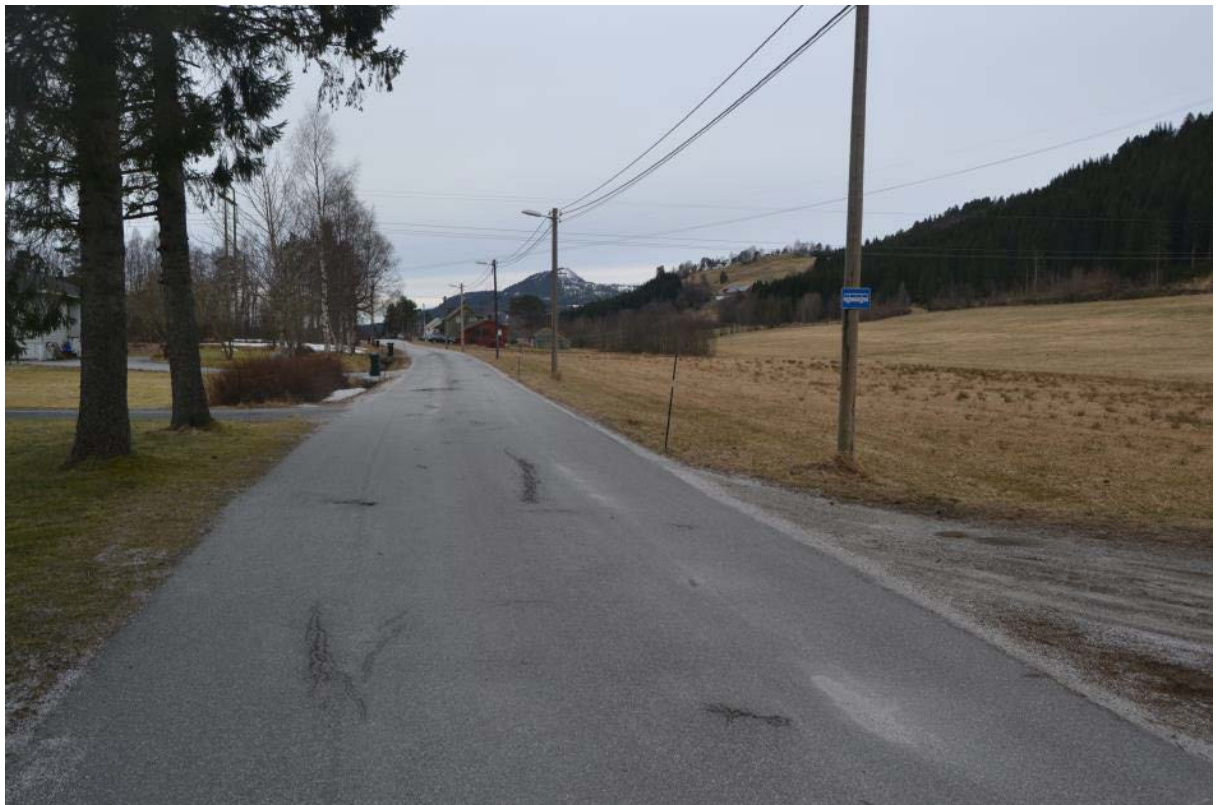
Figur 1: Veistrekket med sprekkdannelse og skader som følge av stokker som presses opp av tele. Foto: Kristoffer Dahle, Møre og Romsdal fylkeskommune
