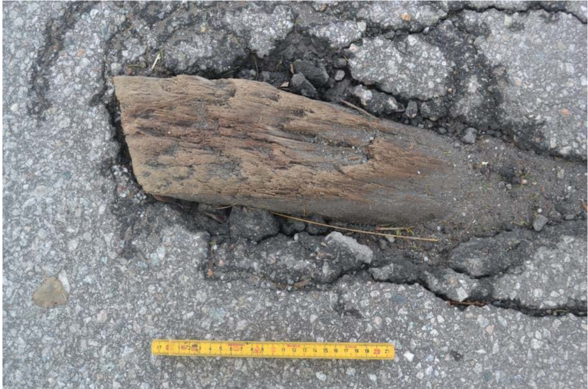
Figur 3: Stokk som er presset opp gjennom asfalt. Foto: Kristoffer Dahle, Møre og Romsdal fylkeskommune
