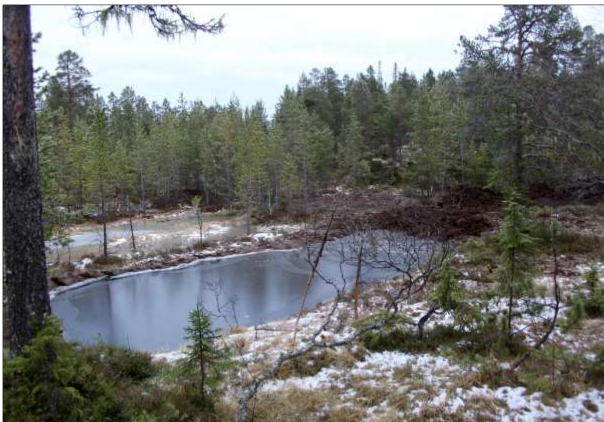
Fig. 4. Ny dam er nesten ferdig, og massen skal planeres ut der den er plassert. Foto: Eva Tilseth.
