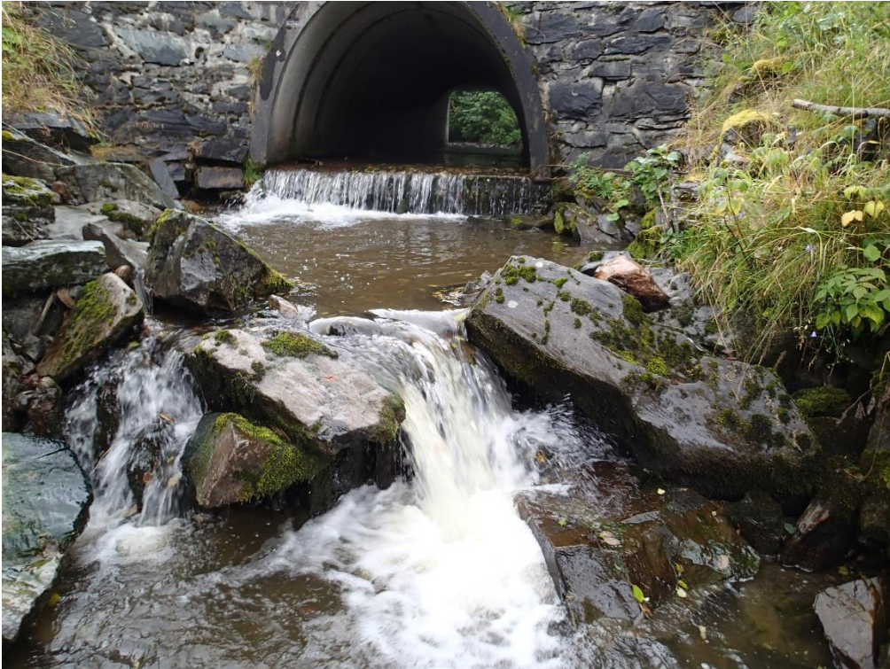
Figur 3. Kulverten under riksvegen og området umiddelbart nedstrøms kan i perioder være vanskelig å forsere for fisk.
