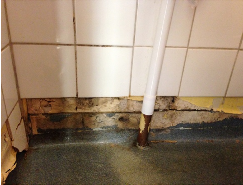
Fuktskader på bad på mottak. Foto: mottak X
